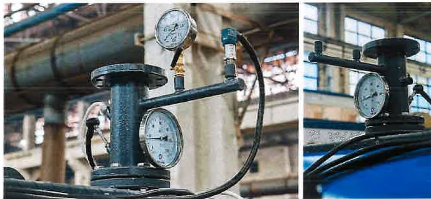
Рис. 12 Пример установки приборов КИПиА на проставках
